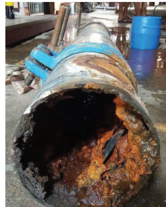
В ходе демонтажа отработавшей трубы происходят массовые разливы углеводородов
